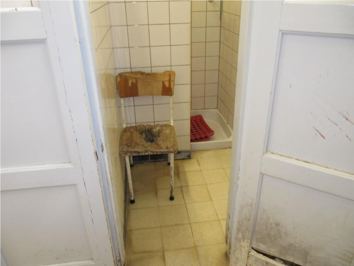
stoel in doucheruimte hospitaal : rot zitvlak
