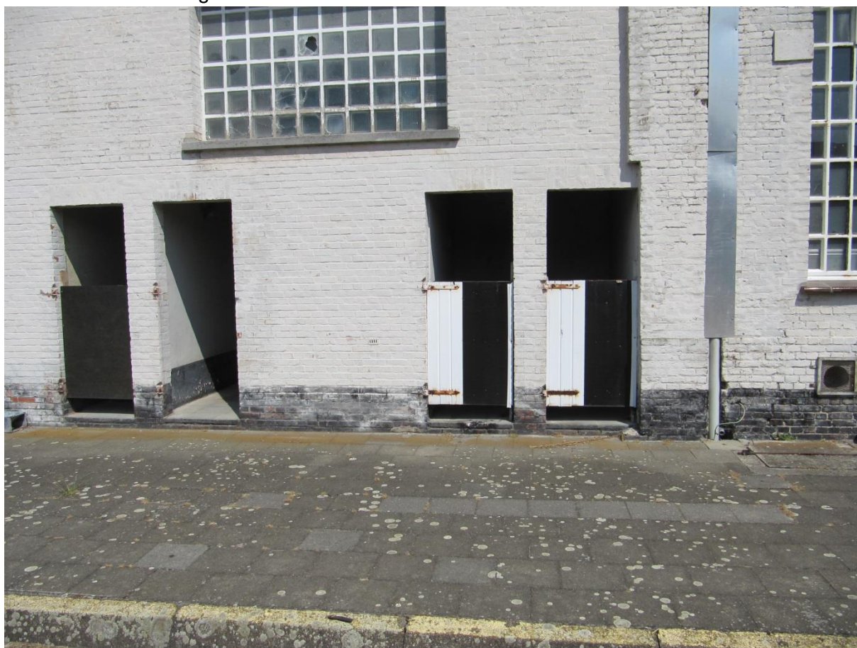
oude toiletten buiten gebruik
