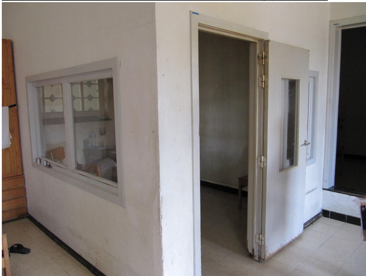
paviljoen 'hospitaal' : rokerskamer in hoek van slaapzaal; het afzuigsysteem is stuk
